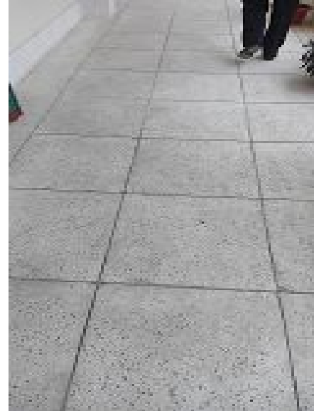
ব্রাহ্মণবাড়িয়া পৌর ডিগ্রি কলেজের করিডোরের মেঝেতে নিম্নমানের মোজাইক কাজ
