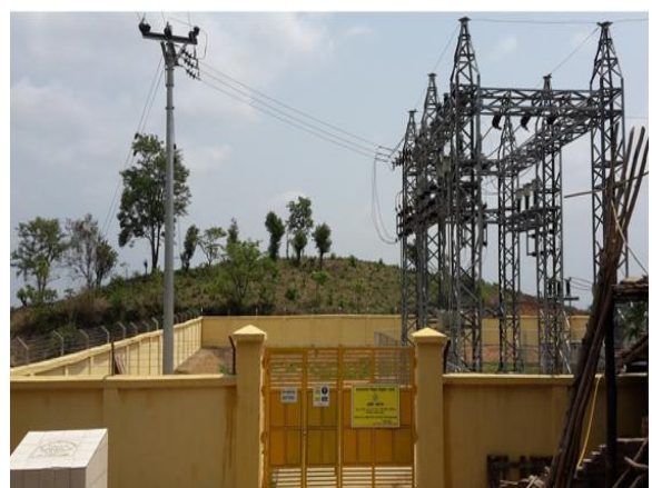
চিত্র-২: বান্দরবানের ওয়াইজাংশন ৩৩/১১ কেভি ৫/৬.৬৭ এম.ভি.এ ক্ষমতাসম্পন্ন নির্মিত গ্রামীণ টাইপ উপকেন্দ্র
