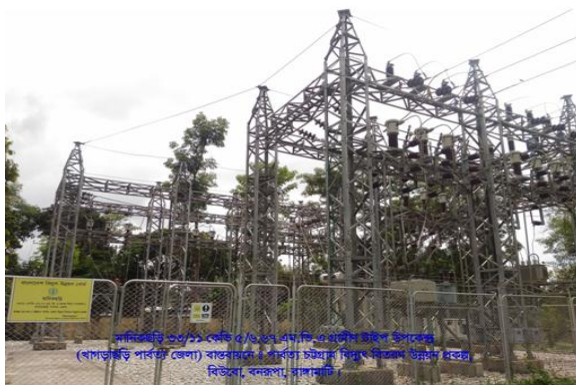
চিত্র-১: খাগড়াছড়ির মানিকছড়ি উপজেলাধীন ৩৩/১১ কেভি ৫/৬.৬৭ এম.ভি.এ ক্ষমতাসম্পন্ন নির্মিত গ্রামীণ টাইপ উপকেন্দ্র
